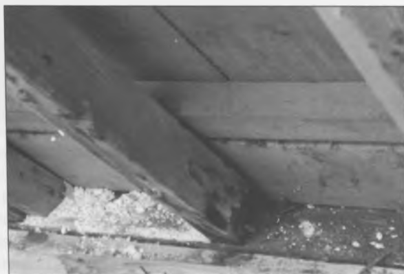
Door het verwijderen van de gipsplaten kwamen de aangetaste balken in zicht
